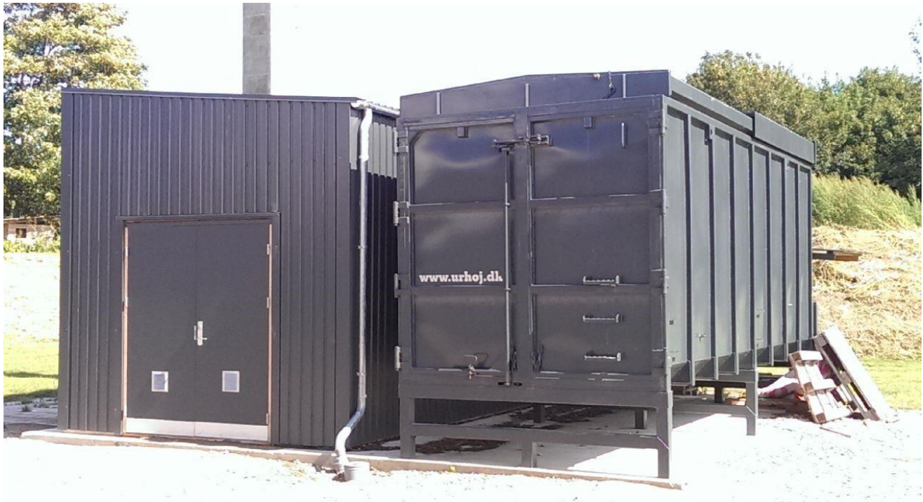
I модуль - котел REKA 250 кВт II- контейнер для палива, пелет і тріски, «жива підлога»
