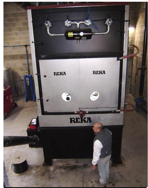
Пуск котла HKRST 2,8 МВт, солома
