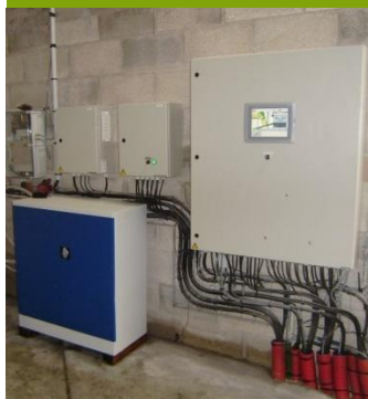
Панель управління 2,8 МВт
